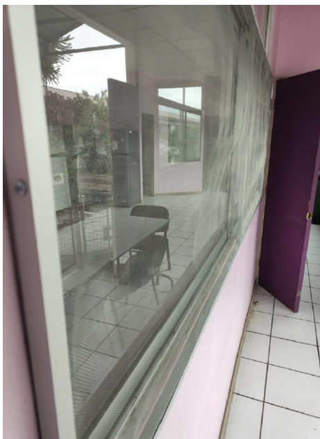
Ilustración 143: Mallas mosqueteras en Salas de Multipropósito. CESFAM Recreo
