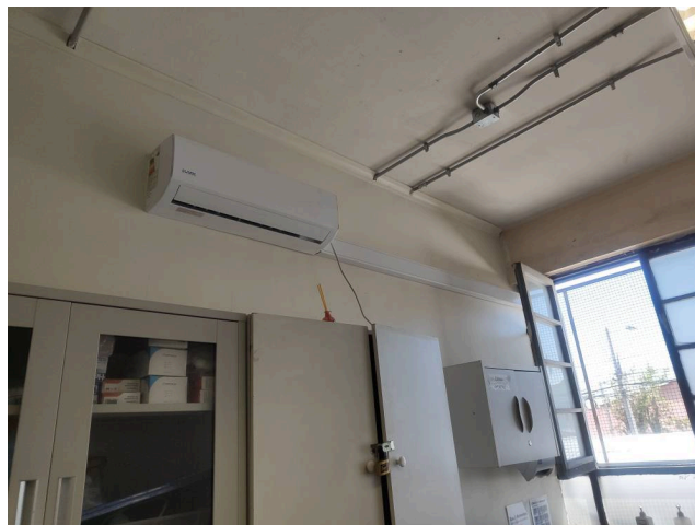
Ilustración 142: Adquisición e instalación de nuevos 25 aires acondicionados para box de multipropósito. CESFAM Recreo
